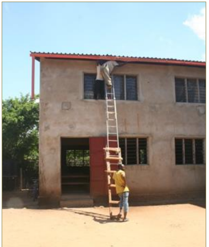
Dakgoten aan het schoolgebouw (opvangen regen water)
