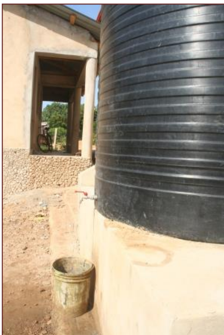
Nieuwe watertank om de handjes te wassen
